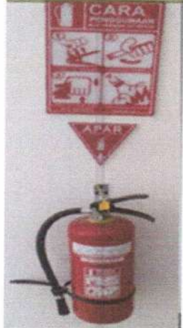
ALAT PEMADAM KEBAKARAN
